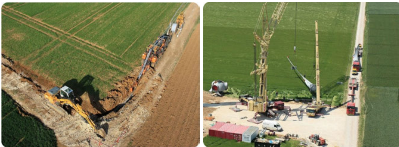
Photo 117 : Intervention d'engins de chantier lors de la construction de la centrale éolienne du Bois Cheneau (source : VOL-V, LGC © 2009 Double J Photos)
