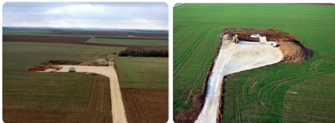
Photo 102 : mise en place des plateformes et accès de la centrale éolienne du Bois Cheneau (source : VOL-V, LGC © 2009 Double J Photos)
