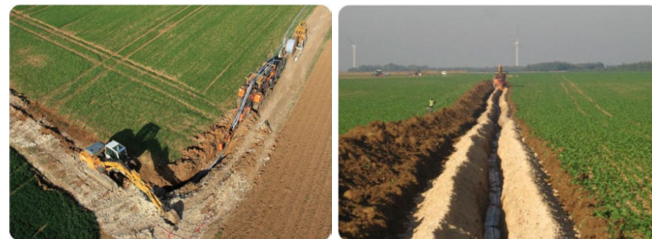
Photo 103 : Mise en place des réseaux de la Centrale éolienne du Bois Cheneau (source : VOL-V, LGC © 2009 Double J Photos)
